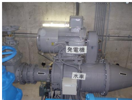
使用している発電機
