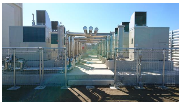
消化ガス発電施設
