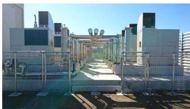
消化ガス発電施設
