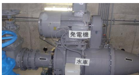
使用している発電機
