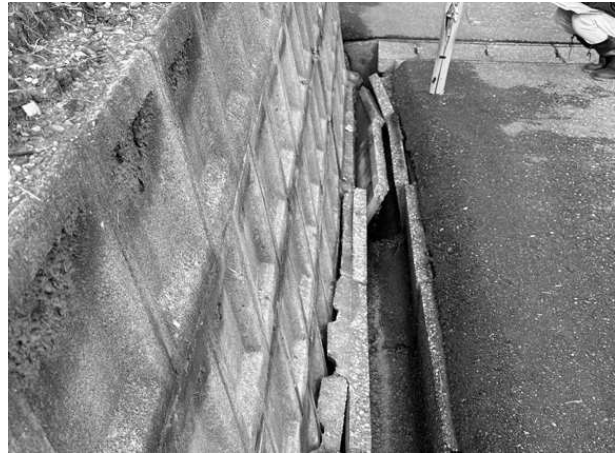
〔中門前団地北 10 号線〕 側溝破損
