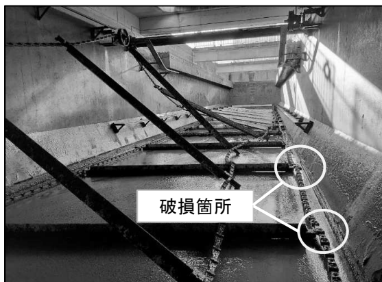
▲フライト板の破損
