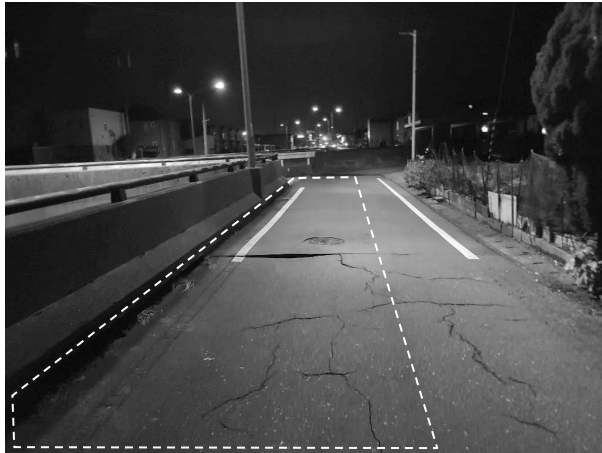
〔石橋二丁目居多ヶ浜線〕 舗装陥没
