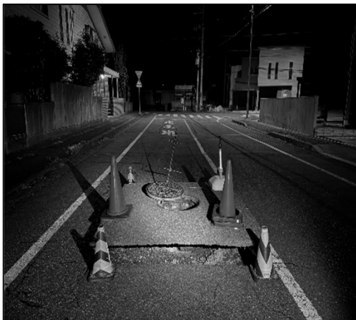
▲マンホールの浮上
