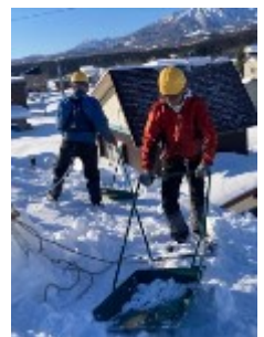
▲屋根雪下ろし
