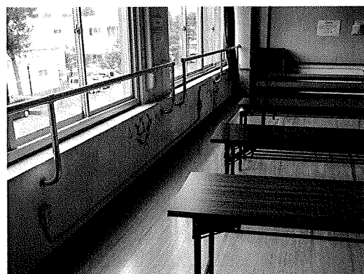
▲壁のクラック
