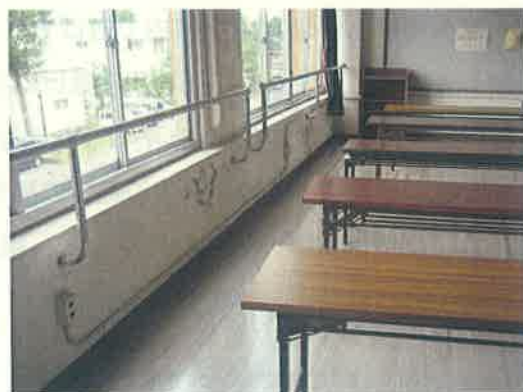
▲壁のクラック
