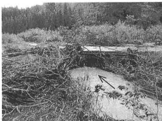
土口地内 【土砂堆積】
