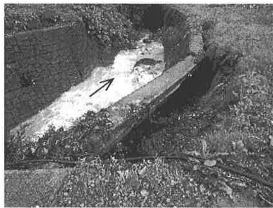
板倉区久々野地内 【護岸洗掘】
