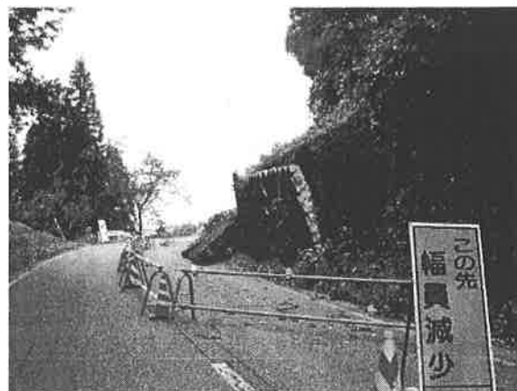
名立区 市道桂空熊線【法面崩壊】
