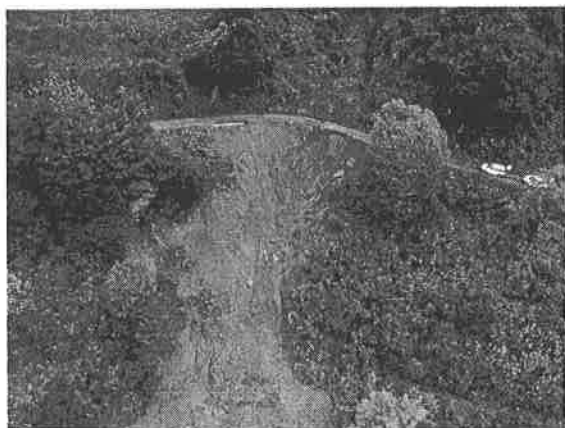
清里区 市道赤池上牧線【路肩崩落】
