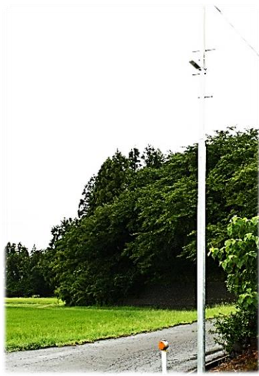
▲板倉区に通じる三叉路に立つLED防犯灯
