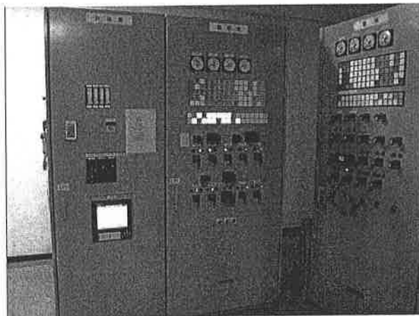
計装盤・監視盤更新 (電気設備)
