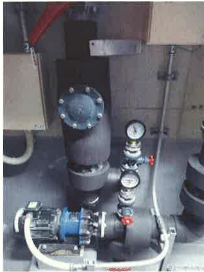
図5. ポンプ機械基礎・配管 壁への直接アンカーの様子
