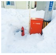
豪雪下で除雪された消火栓
