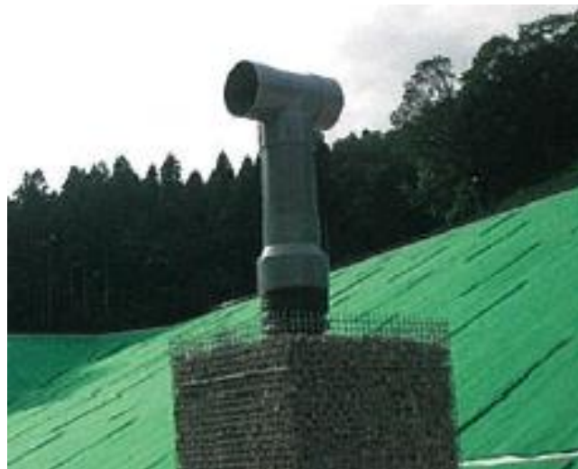
ガス抜き管 先端部
