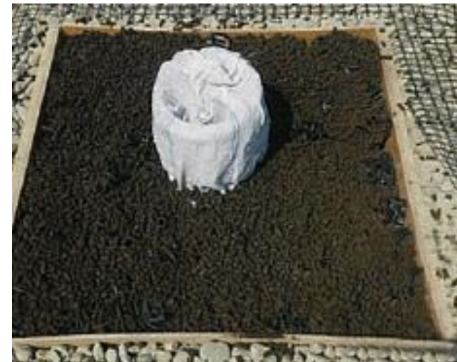
ガス抜き管下部の脱臭剤
