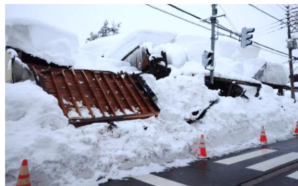
【南本町一丁目地内 倒壊した空き家】
