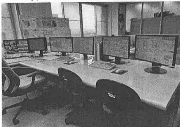
〔下水道センター中央監視設備〕
