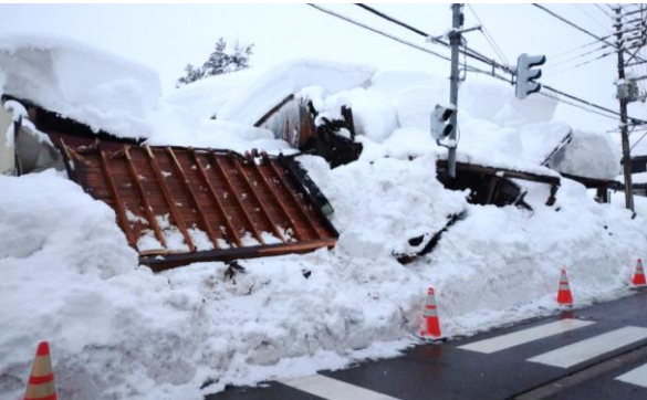
【南本町一丁目地内 倒壊した空き家】
