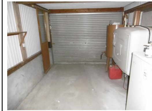
車庫(ボイラー室)
