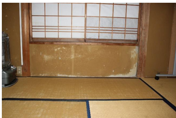
和室のささくれた畳と剥がれた壁
