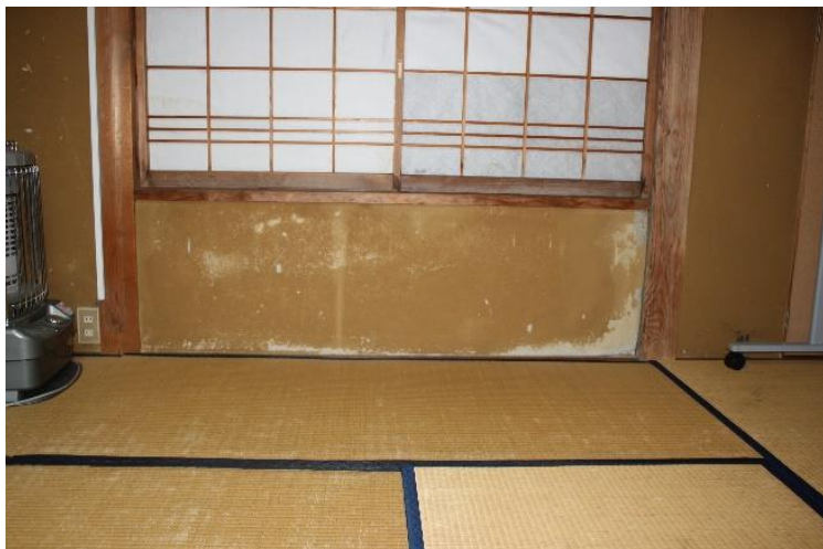
和室のささくれた畳と壁
