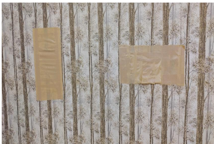
集会室の剥がれた壁
