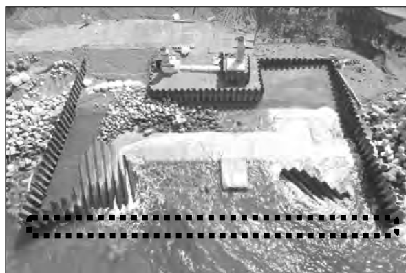
仮締切鋼矢板の倒壊状況（9月26日撮影）
