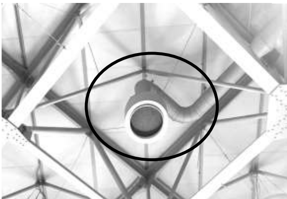
上越市総合体育館（アリーナ天井換気ダクト）
