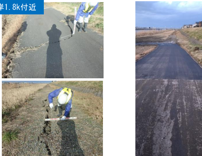
堤防坂路および管理用通路 被災状況
