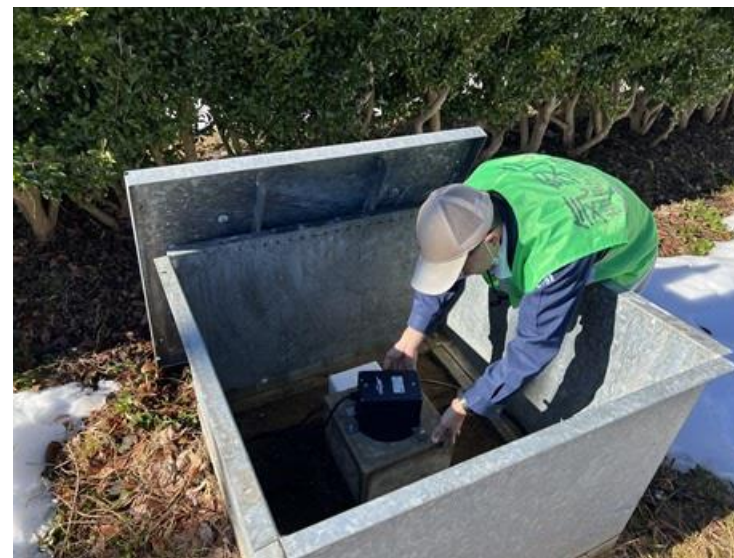
震度計感部の点検（上越市吉川区）
