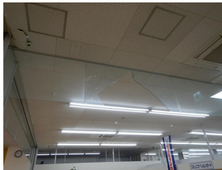
天井やパラスモークの破損（長岡市中之島）
