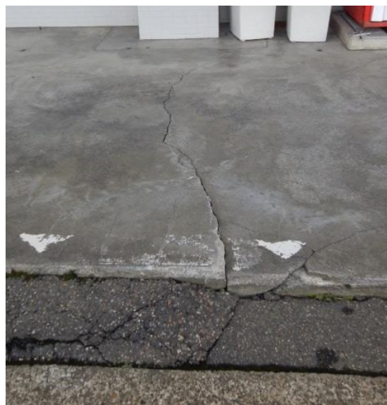
コンクリートの損傷（長岡市中之島）
