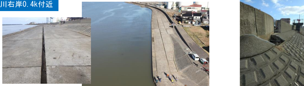
コンクリート目地の開き 及び 堤防損傷状況
