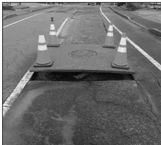
▲マンホールの浮上
