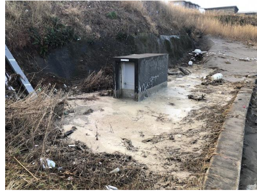
海水取水施設周辺の海水貯留状況
