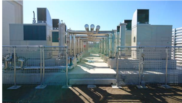
消化ガス発電施設
