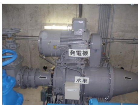
使用している発電機
