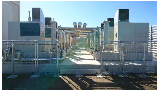
消化ガス発電施設
