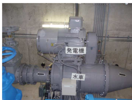
使用している発電機
