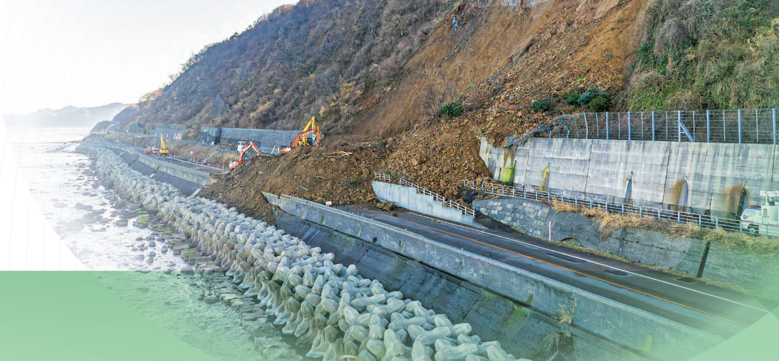
㊦: 国道8号茶屋ヶ原付近の土砂崩れ
