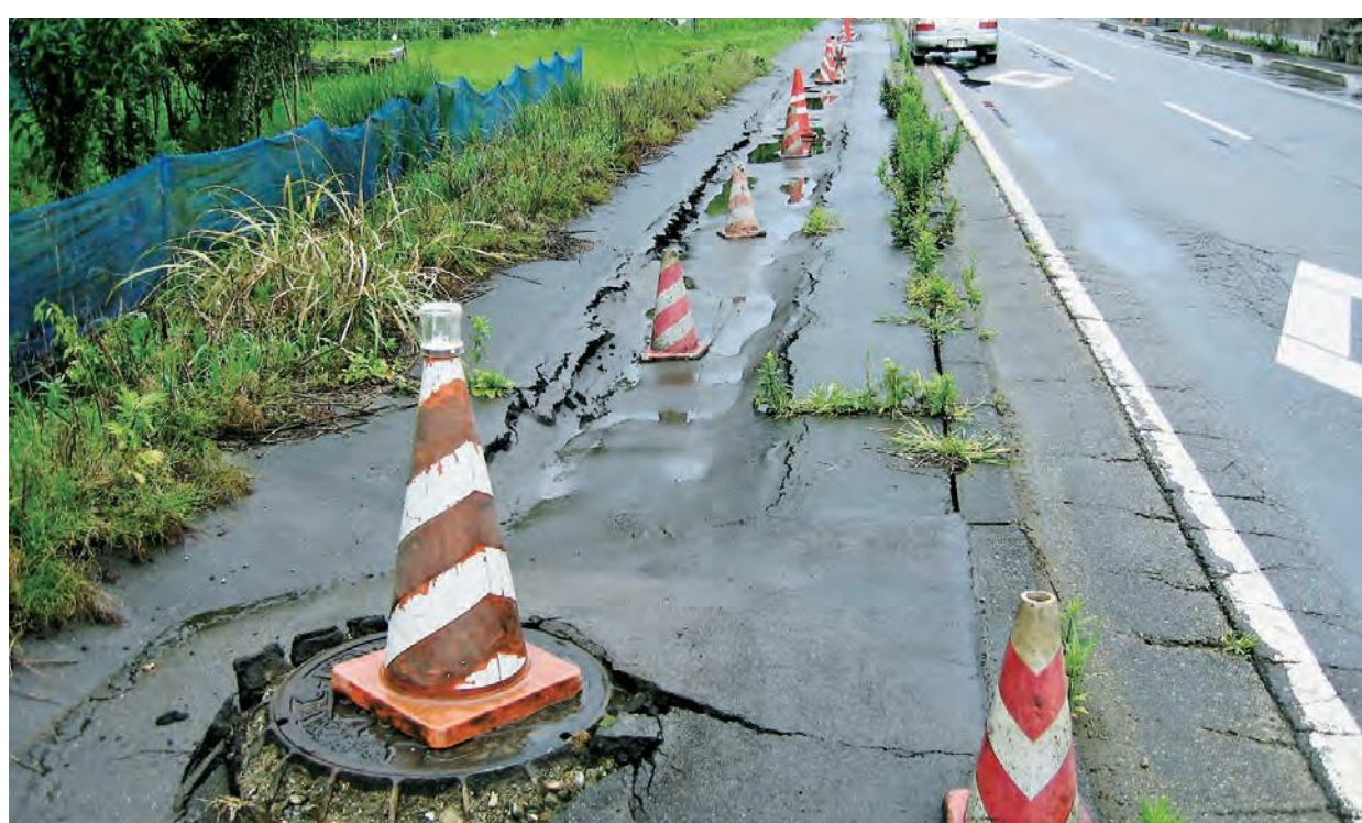
吉川区の歩道のひび割れ
