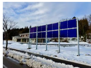
新金谷地区公民館に設置した 垂直型両面太陽光発電設備
