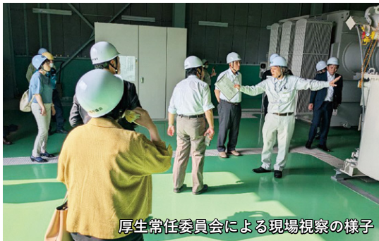
故障した変圧器
