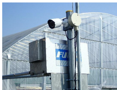
防犯カメラの設置
