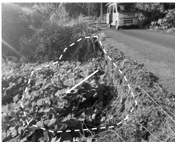
路肩崩落（山本岩室線：浦川原区山本地内）
