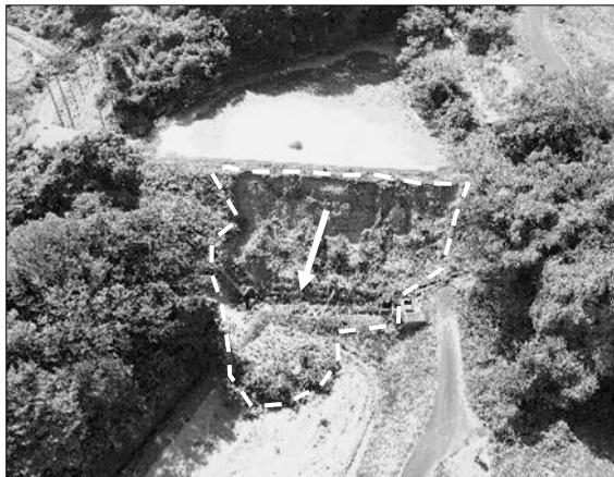
ため池法面崩落（下宇山地内）
