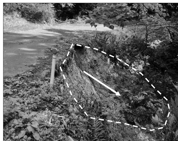
路肩崩落（湯ノ入線：頸城区大蒲生田地内）
