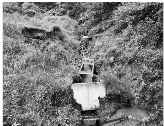
水路崩落（吉川区長坂地内）
