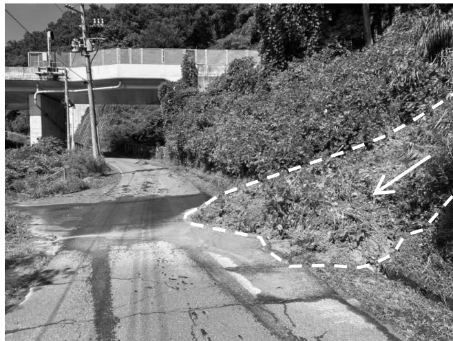
〔合併前上越市 高住長浜線〕 法面崩落
