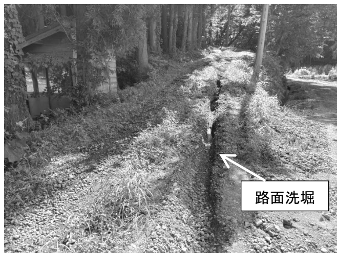
〔吉川区 福平長坂線〕 路面洗堀
