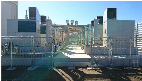
消化ガス発電施設
