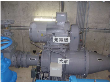
使用している発電機
