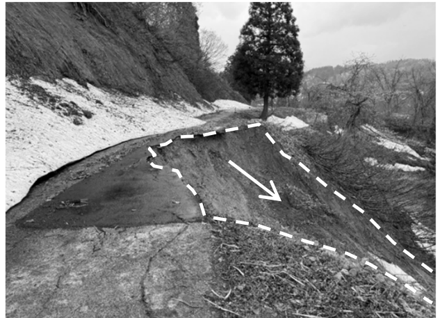
〔朴ノ木上用水線〕 道路崩落
