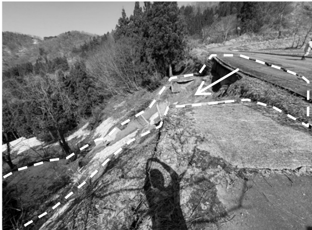
〔東頸城幹線〕 道路崩落
