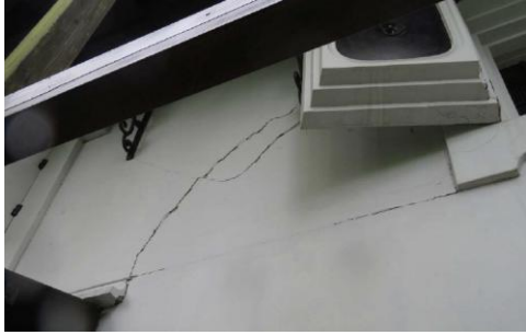
▲漆喰壁 亀裂（北側）
