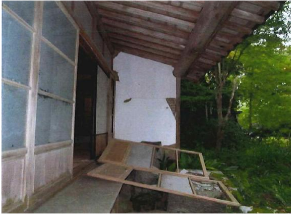
▲北側 下屋 被災後
