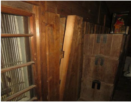
▲蔵 2階 壁材 外れ
