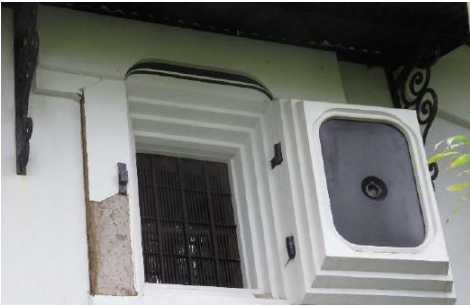
▲漆喰壁 剥離（北側）
