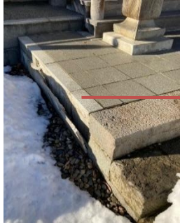
▲向拝石積 剥離
