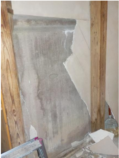
▲漆喰壁 剥離（南側）
