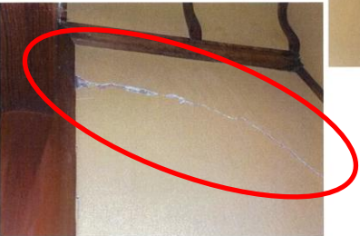
▲松の間 床の間 被災後
