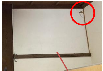
▼内陣の漆喰塗り壁 亀裂
