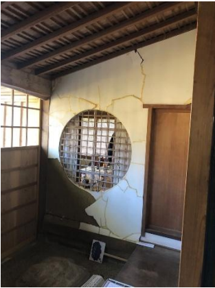
▲ドイン（北縁側）丸窓 被災後
