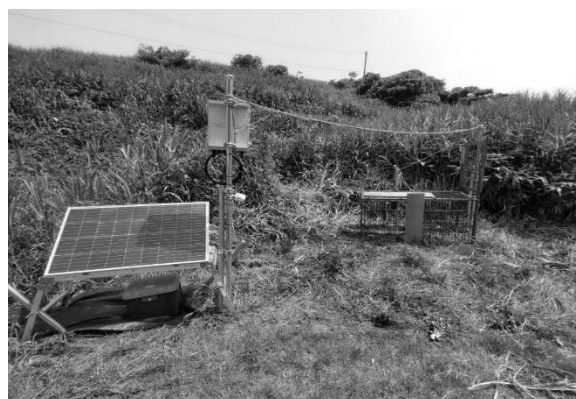
[箱わなの遠隔操作システム（柿崎区）]
