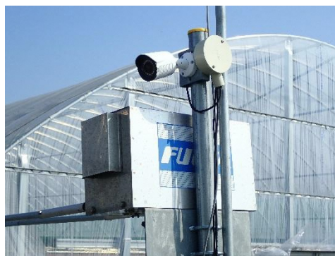
防犯カメラの設置
