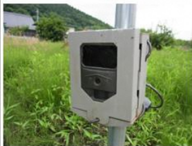
防犯カメラの設置
