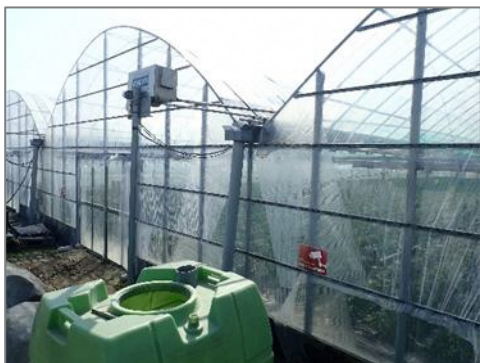
防犯カメラの設置
