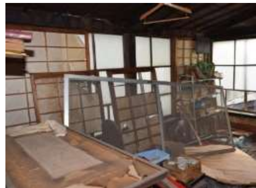
老朽化が著しい内部の様子
