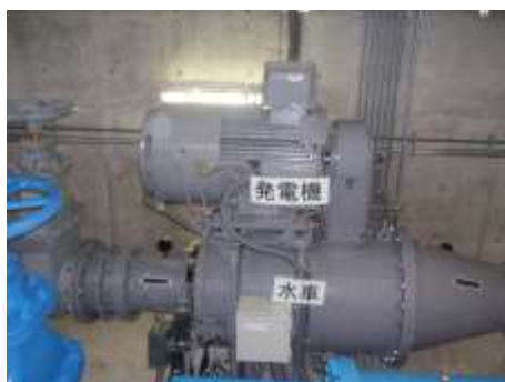
使用している発電機
