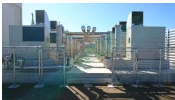
消化ガス発電施設
