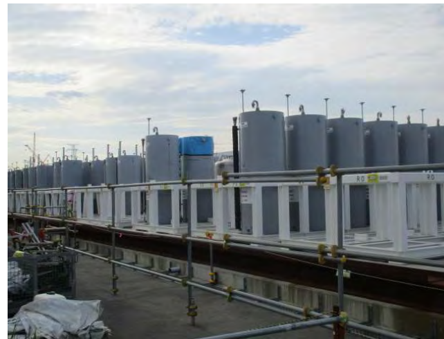
汚染水処理後の保管タンク群
