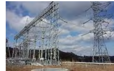
新福島変電所
