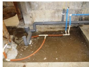
新設トイレの給排水管
