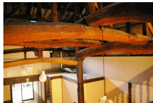
(上段) 途中で切断された吹抜の小屋束に受梁設置 (下段) 洋風の柱頭飾りとペンキ塗壁、天井を復元
