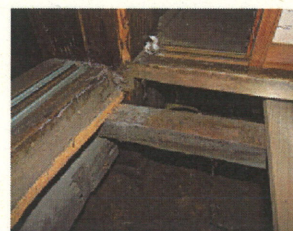
シェアハウス大町の床下
