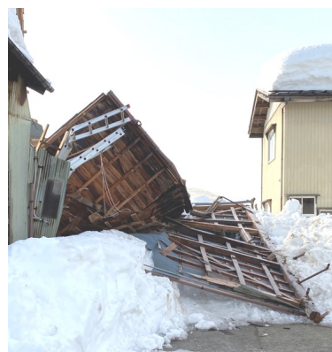
全壊した作業所
