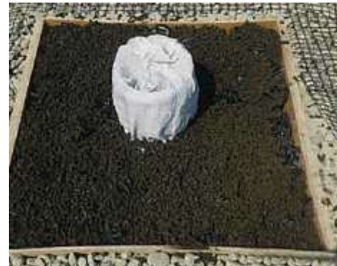
ガス抜き管下部の脱臭剤
