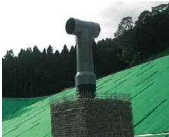
ガス抜き管 先端部
