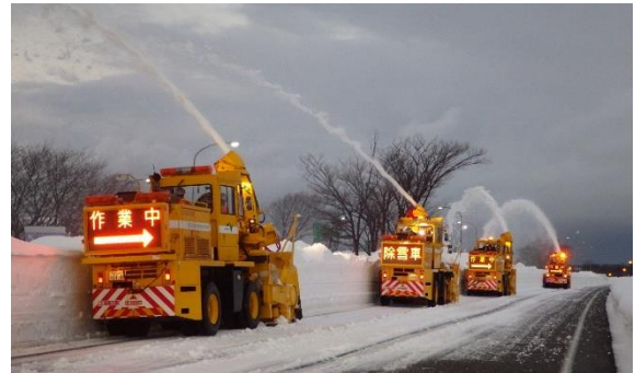
【北陸自動車道 (大湊 PA 付近)】 (ロータリー除雪車による梯団除雪の状況) 1 月 13 日撮影
