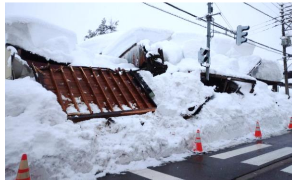
【南本町一丁目地内 倒壊した空き家】
