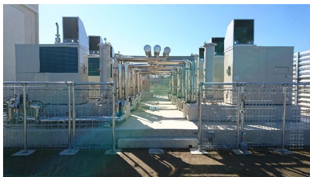
消化ガス発電施設
