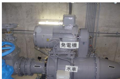
使用している発電機
