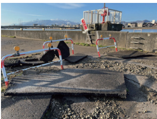
津波の破壊力
