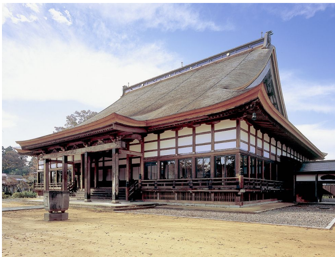
まちづくりの拠点となっている 保存修理された浄興寺 じょうこうじ
