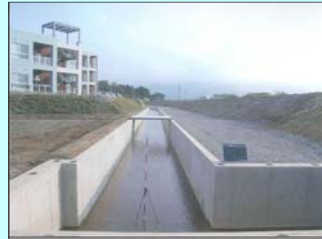
下水道(雨水: 脇野田第三排水区)
