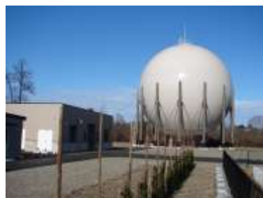
大潟ガス供給所 平成 20 年 11 月完成
